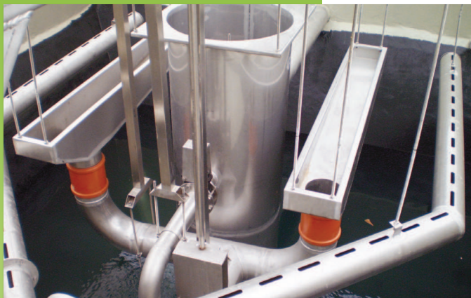
Technologické vybavení dosazovací nádrže
